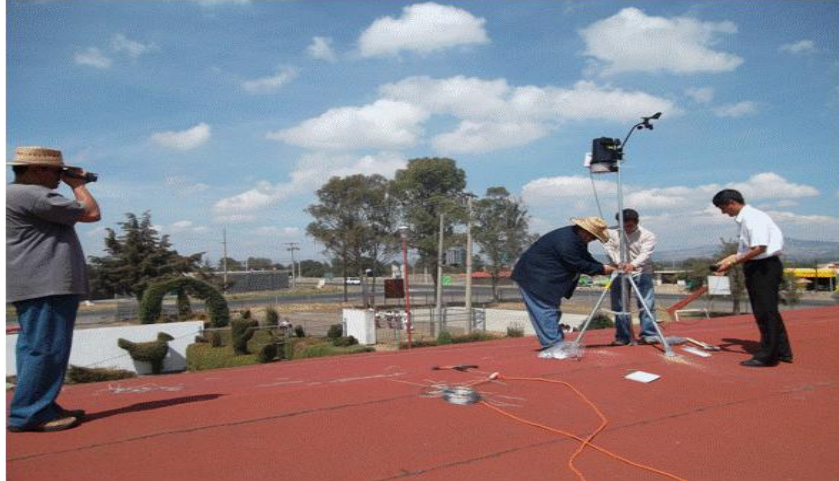
Fig. 5 Proceso de instalación estaciones meteorológicas, 5a; despliegue de información a través de weather link , 5b.
